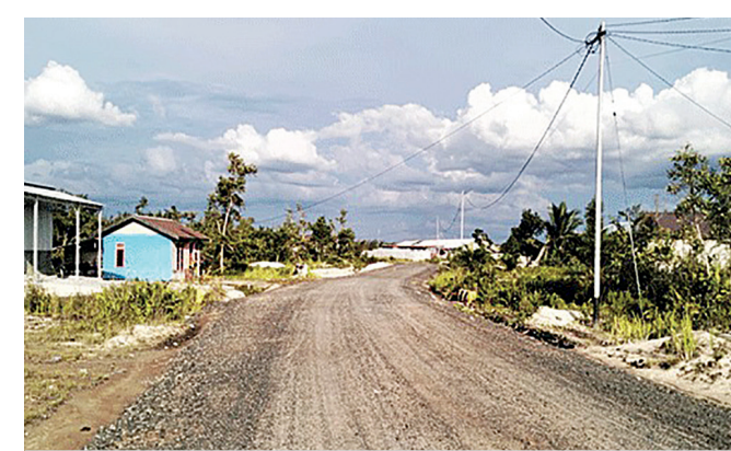
Proyek Rekonstruksi Jalan Bukit Batu-Sei Gita senilai Rp 10 Miliar, yang diduga dijadikan ajang korupsi. (Foto:Mandau)
