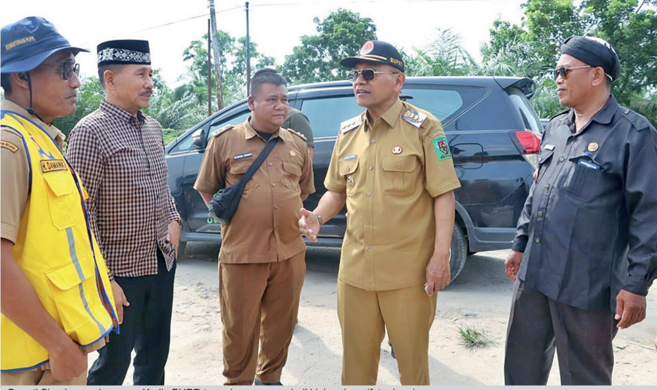
Bupati Simalungun bersama Kadis PUPR turun langsung perbaikan jalan desa. (foto: hms)
