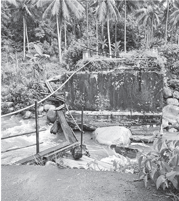
Kondisi jembatan rusak dan jembatan gantung baru. (Foto/Hariyanti)
