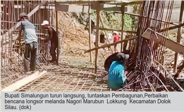
Bupati Simalungun turun langsung, tuntaskan Pembangunan, Perbaikan bencana longsor melanda Nagori Marubun Lokkung Kecamatan Dolok Silau. (dok)
