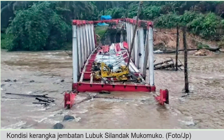
Kondisi kerangka jembatan Lubuk Silandak Mukomuko. (Foto/Jp)
