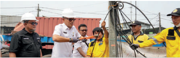
Pemkot Jakarta Timur menertibkan dan menata kabel udara yang semrawut di sepanjang Jalan Sultan Hamengkubuwono IX.(dok hms)
